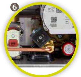
Valvola 3 vie posta sul ritorno riscaldamento
